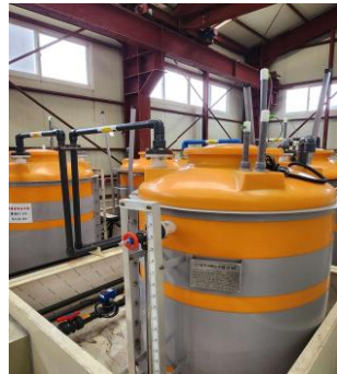
수산화 나트륨 소분 탱크 수산화 칼륨 소분 탱크 탄산 칼륨 소분 탱크 황산 61.5% 소분 탱크
